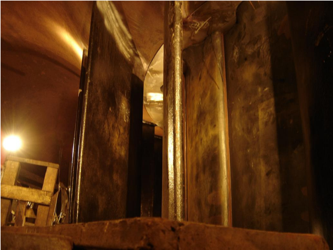
Figura 19 – Travessas da Unidade 03 de UHE Capivara com palhetas distribuidor fechadas ao fundo
