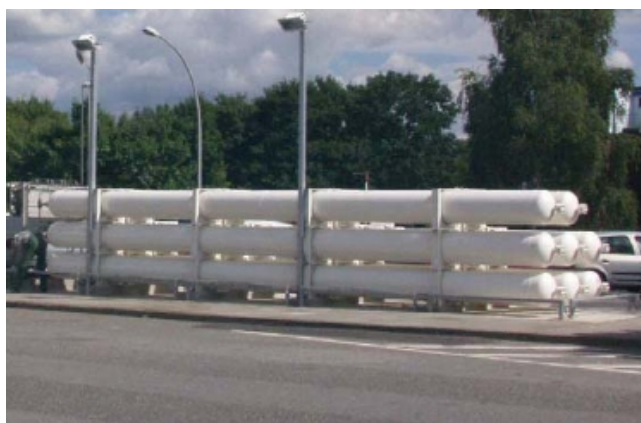
Fig. 12 - Central de armazenamento de hidrogênio em Hamburgo.
