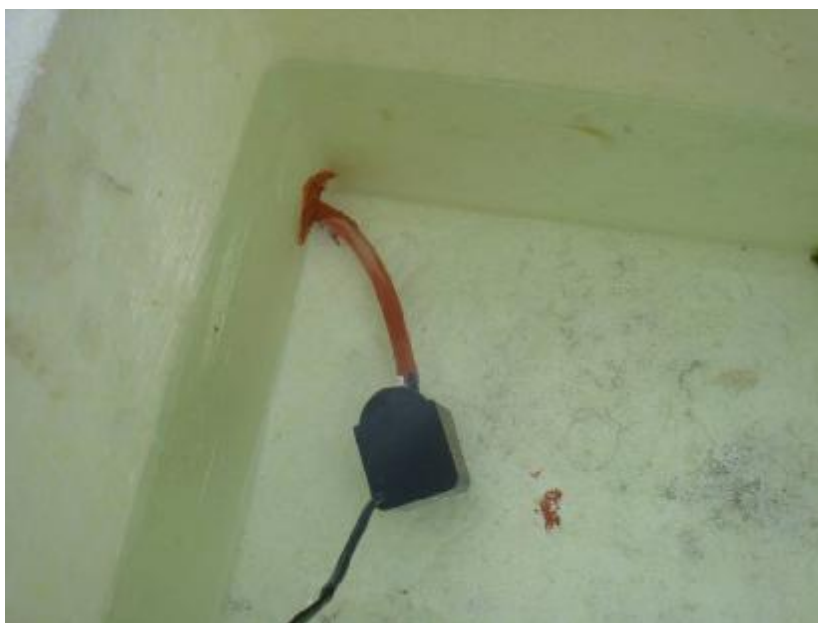
Foto 9 - Posicionamento da bomba no interior do reservatório
