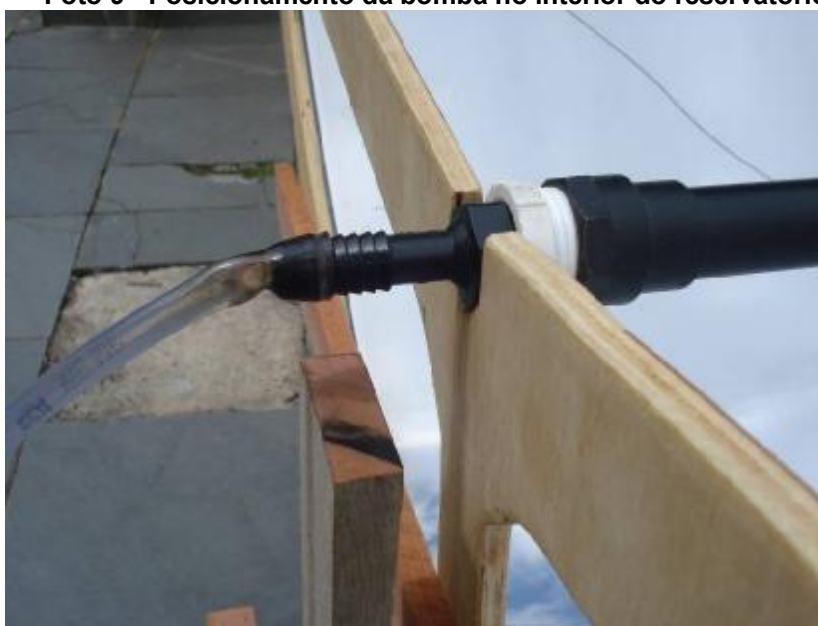
Foto 10 - Conexões na extremidade do tubo
