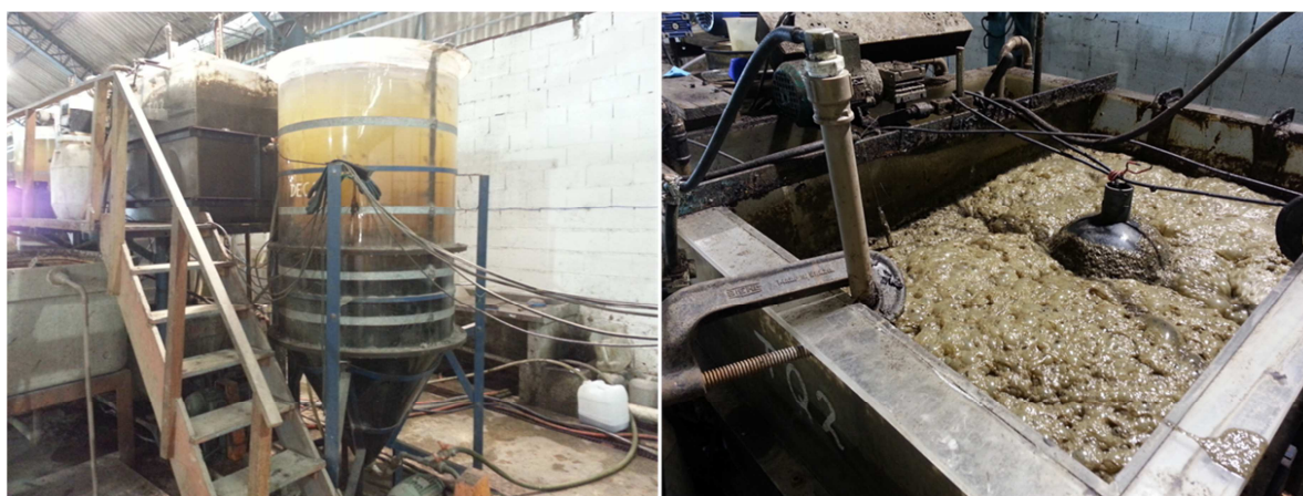
Figura 6: Estação piloto de tratamento híbrido de efluentes do CTH, com destaque para o tanque de tratamento com lodo ativado e enchimento com microrganismos adsorvidos.
