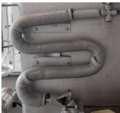
Figura 4.10: Tubo de retenção T1 do pasteurizador FT-43A
