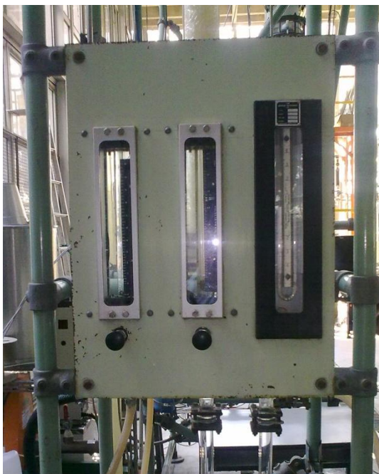
Figura 11 – Painel de controle da operação da coluna, com dois rotômetros e um medidor de perda de carga.
