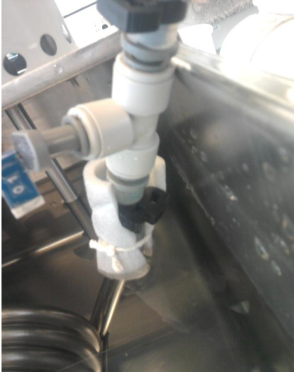
Figura 37 - Camada de isolante térmico na tubulação anterior ao trocador de calor (Termopar 1)
