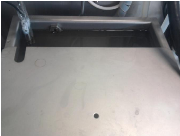
Figura 34 - Água quente armazenada no pausterizador
