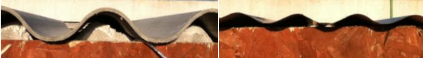
Figura 23: Ondulação das telhas conjunto 1 e 2, respectivamente.
